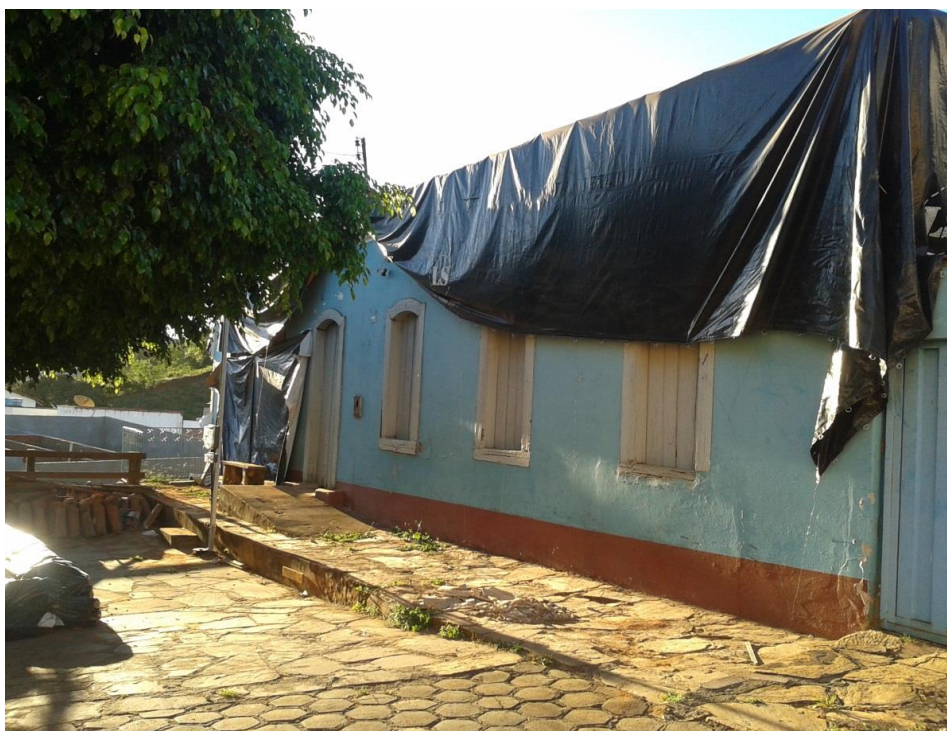
Figura 21: Fachada da Casa da Chácara (após a contenção para evitar danos no período das chuvas). Zamana Brisa. 2015
